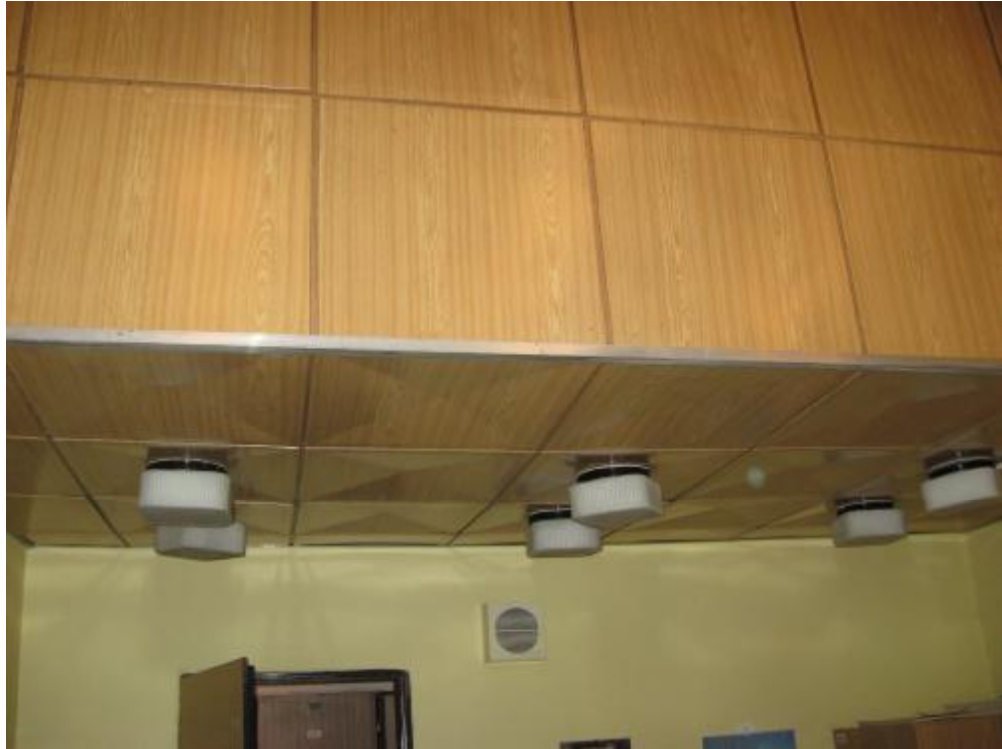
Kazetový verzalitový podhled v kanceláři
