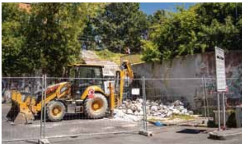
STARÉ SCHODY MUSELY BÝT KVŮLI NARUŠENÉ STATICE ZCELA ZBOURÁNY. FOTO: LIBOR SOLAŘ
